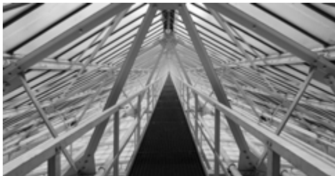
Metalen structuur van het glazen dak van de lokettenzaal © Patrick Van Den Branden, NBB
